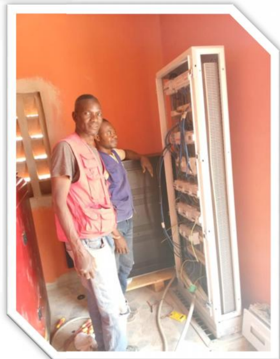
e quello elettrico
